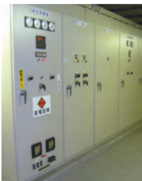
市役所6000ボルト変電設備
