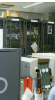
コンピュータ室のサーバー機器他
