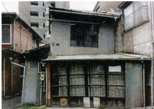
倒壊危険がある空き家 (県の資料参照)
