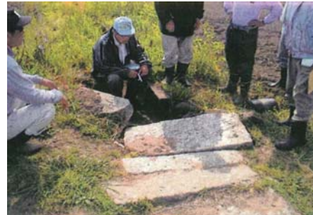
側溝蓋の損傷
