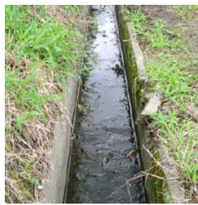
部分的な欠損
