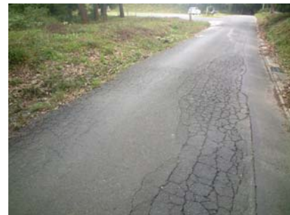
アスファルト舗装の老朽化
