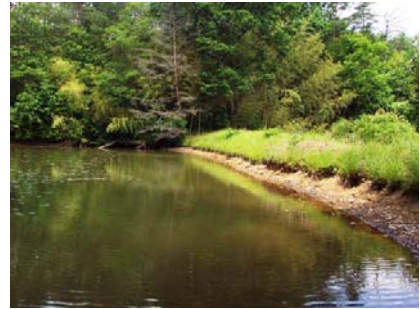
堤体が洗掘されているため池
