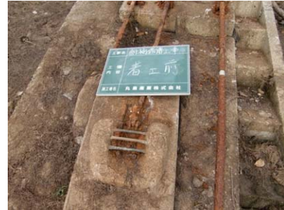
ため池における 老朽化したゲート
