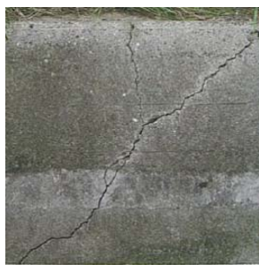
斜め方向のひび割れ
