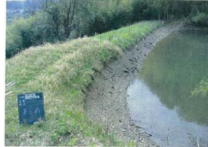
漏水が生じているため池
