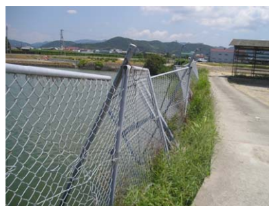
ため池における 破損した金網フェンス
