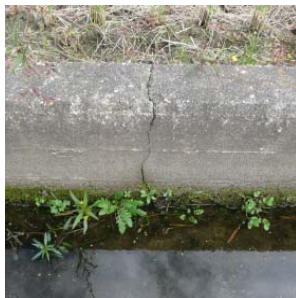
縦方向のひび割れ
