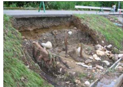
道路法面の崩壊
