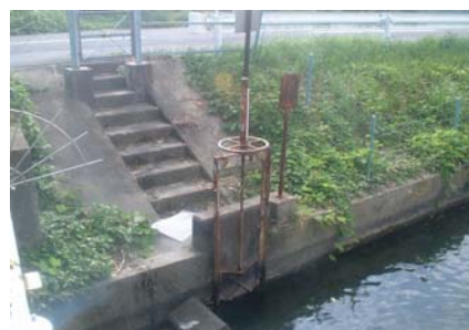
老朽化したゲート
