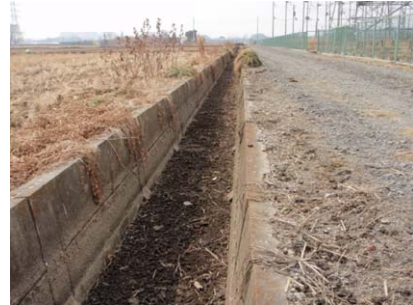
安全施設がない水路
