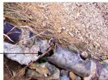
古い樋管（陶製）の破損
