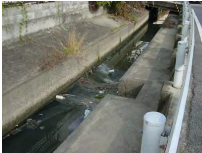
非かんがい期で通水が停止し、雨水のみが滞留して水質が悪化した農業用水路（周辺は新興住宅地）
