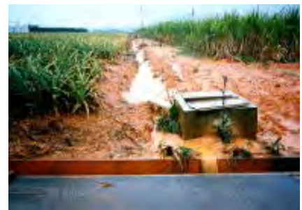
土砂の流出状況
