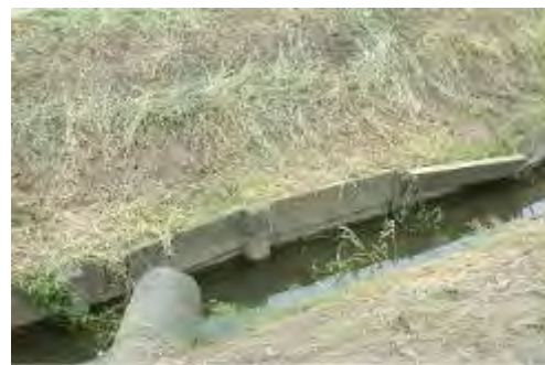
水路側壁のはらみの状況
