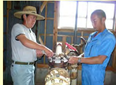
ポンプの点検状況
