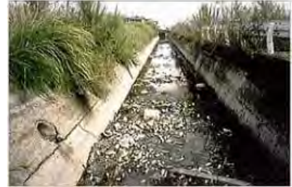
水量が減少した水路
