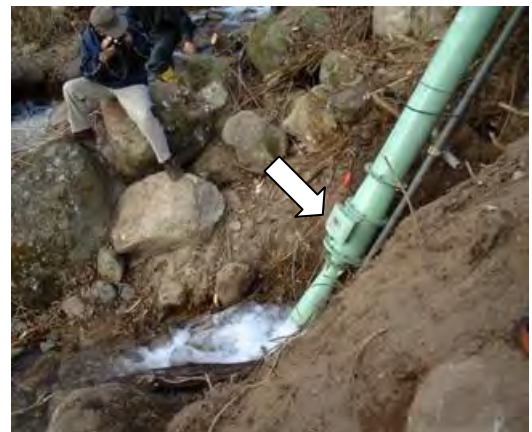
簡易な発電機 (図の矢印)
