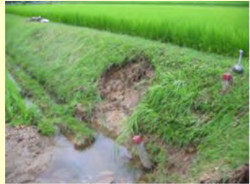
農用地法面が崩れた状況
