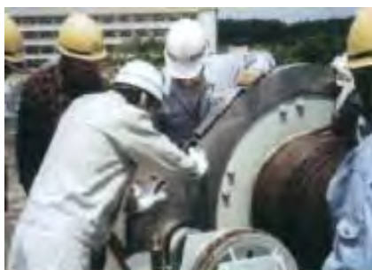
ポンプ点検状況
