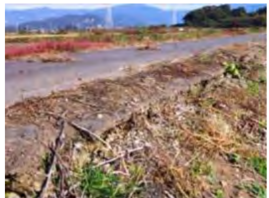
路肩の浸食と路面下の空洞
