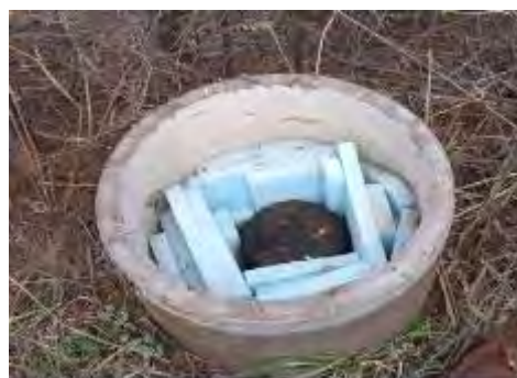
給水栓ボックス内の保温状況
