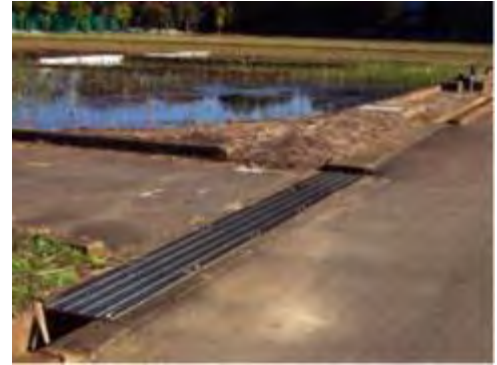
コンクリート蓋とグレーチング
