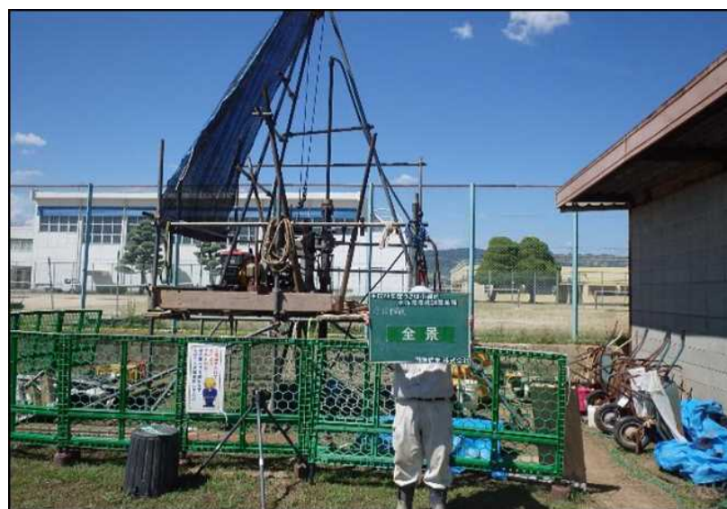
観測井戸設置状況写真
