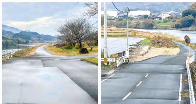
改修工事が待たれる市道下の川～荒瀬線の堤防道路
