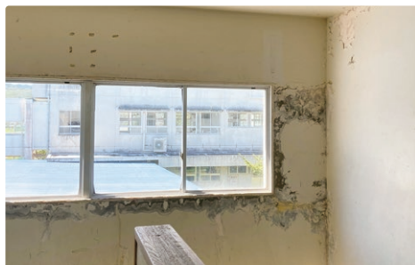
ひび割れ・雨漏り・カビの発生が起きている浮羽中学校校舎
