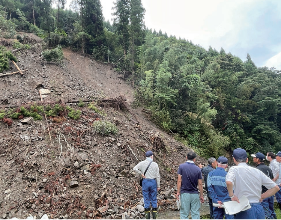
妹川元有地区土砂崩れ
