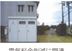
電気料金削減に関連する高電圧変換設備
