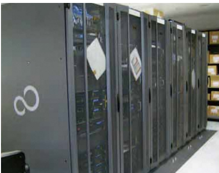
電子計算機本体(データを保存するサーバー)
