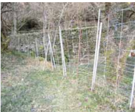
侵入された防止柵
