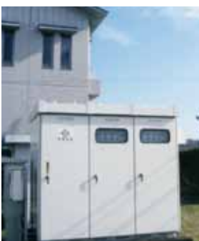
電気料金削減に関連する 高電圧変換設備
