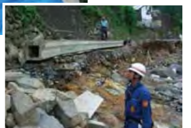
被災状況調査
