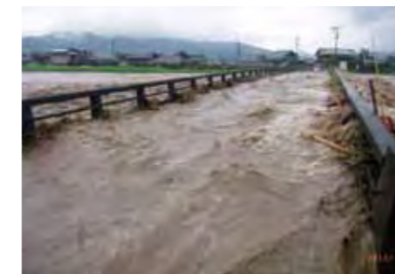
橋の路面を越えた水(隈上川:下御所橋)
